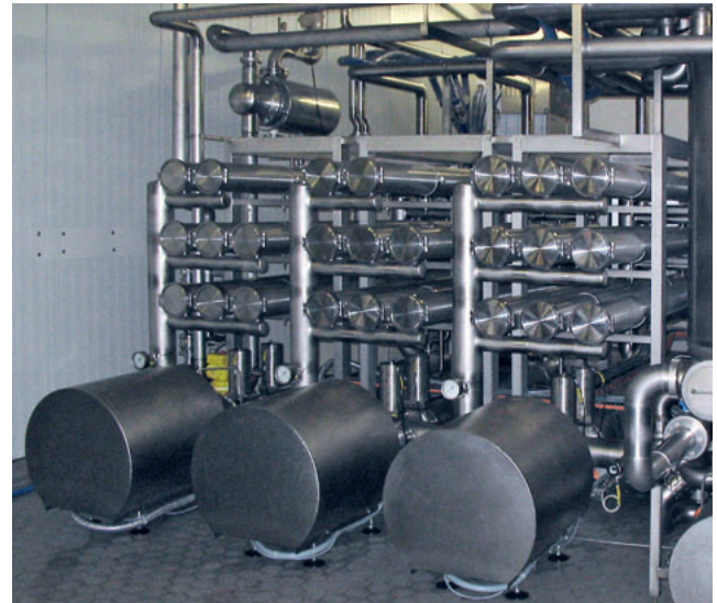
UF-Anlage zur Herstellung von Molkeproteinkonzentrat. Ultrafiltration plant for production of whey protein concentrate.
